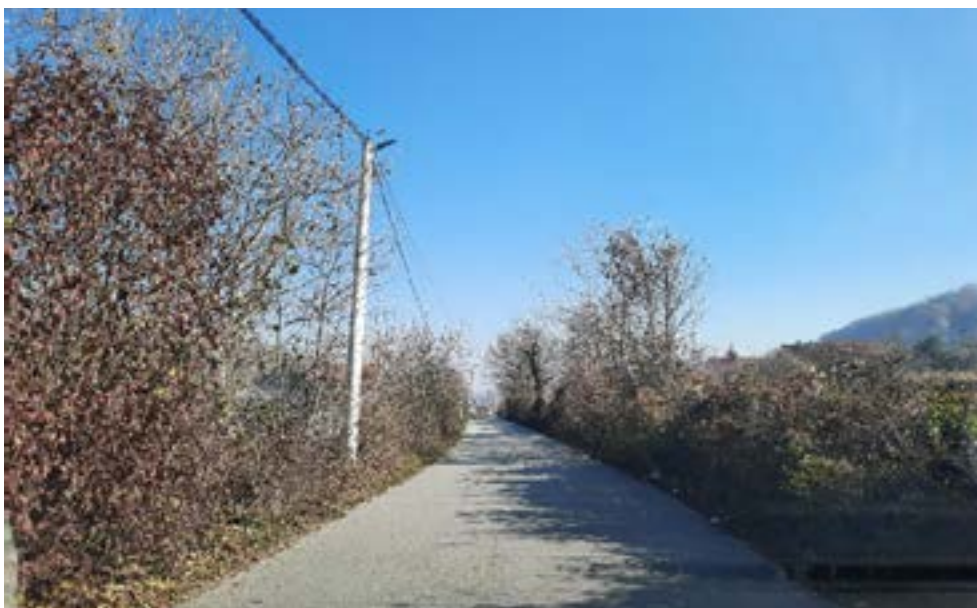
Fotografija snimljena 26. novembra u jednom kvartu u kojem je postavljena LED tehnologija javne rasvete, selo Firaja, Štrpce
