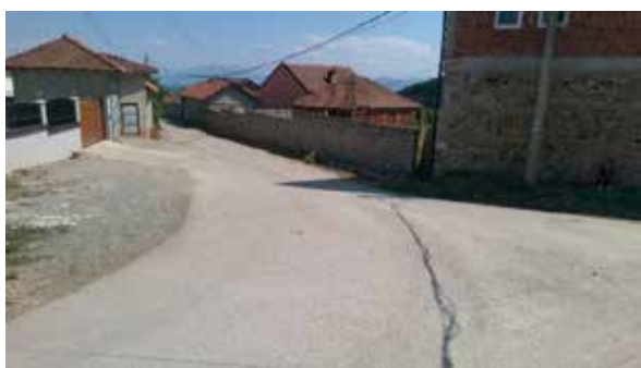
Sl. 7. Nedostatak signalizacije
